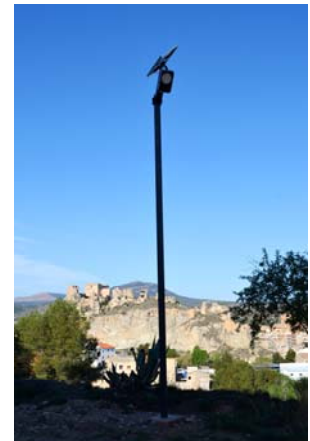
Lámpara LED instalada en Los Calderones
